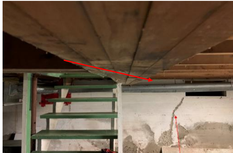
Fléchissement d'éléments structurels et des planchers Bending of structural elements and of floors
