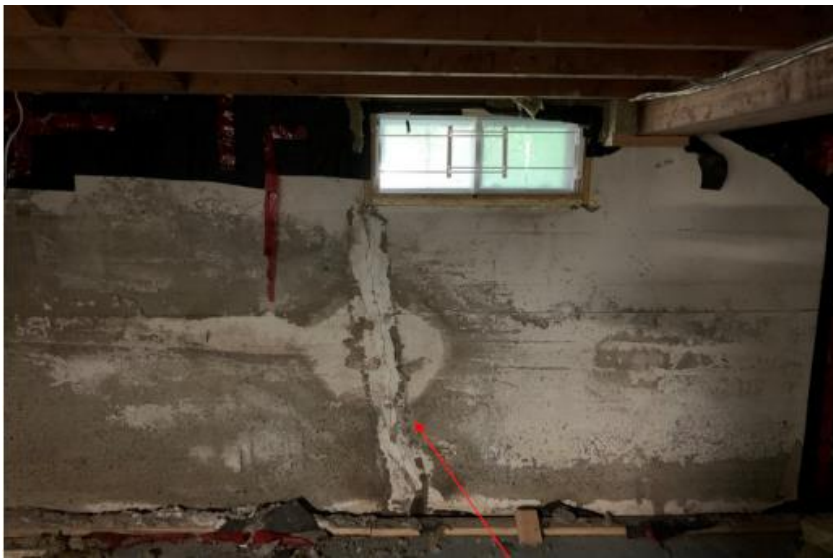
Fissures sur la fondation Cracks in the foundation
