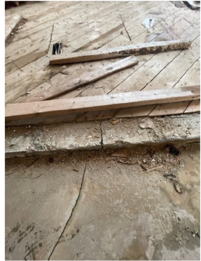
Photo 2 : Éléments en béton armé fissurés
