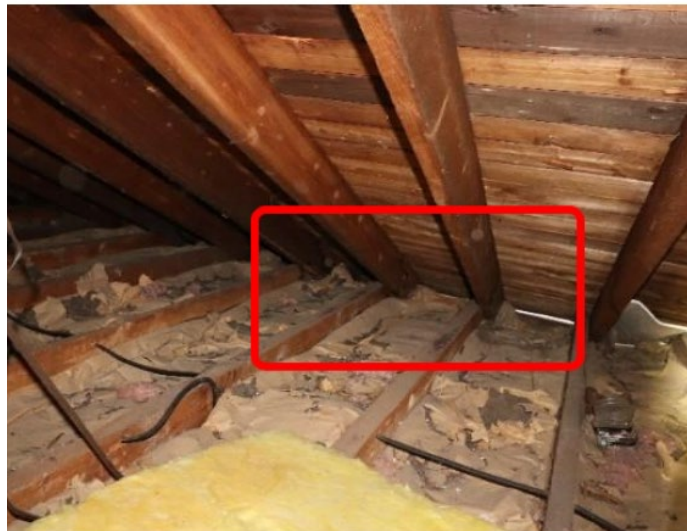
traces de moisissure traces of mold
