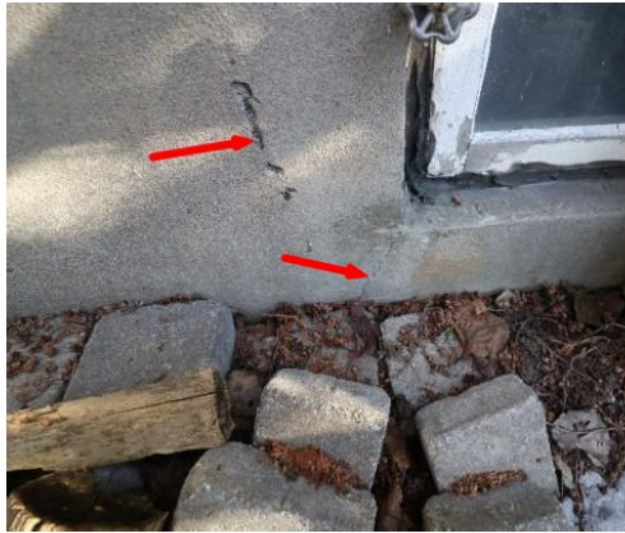
fissures sur la fondation cracks in the foundation
