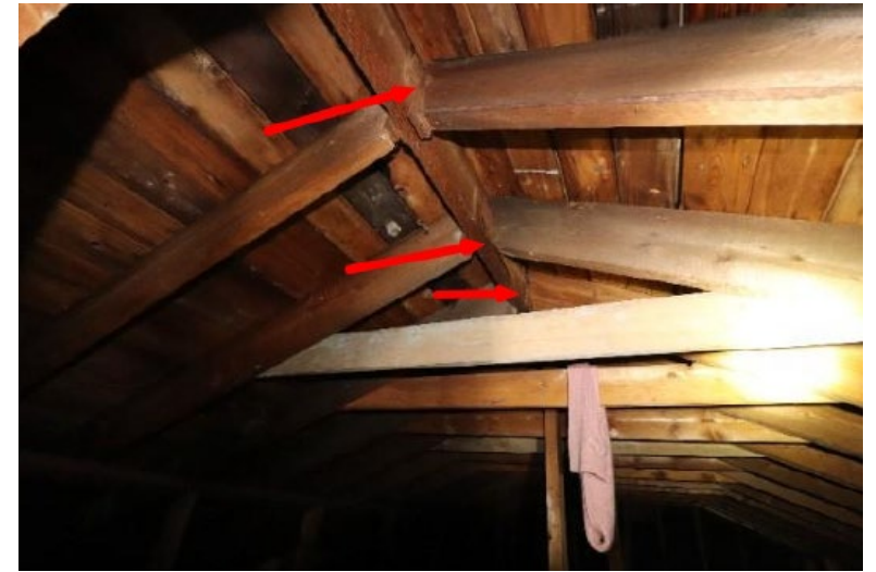
Fléchissement de plusieurs composantes de la structure du toit Deflection of several structural components of the roof
