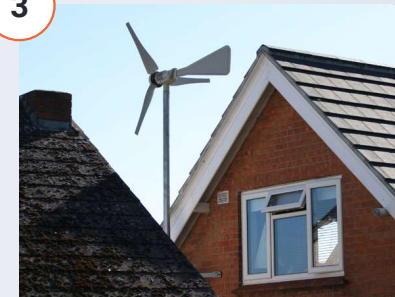
Éolienne domestique / Residential wind turbine
