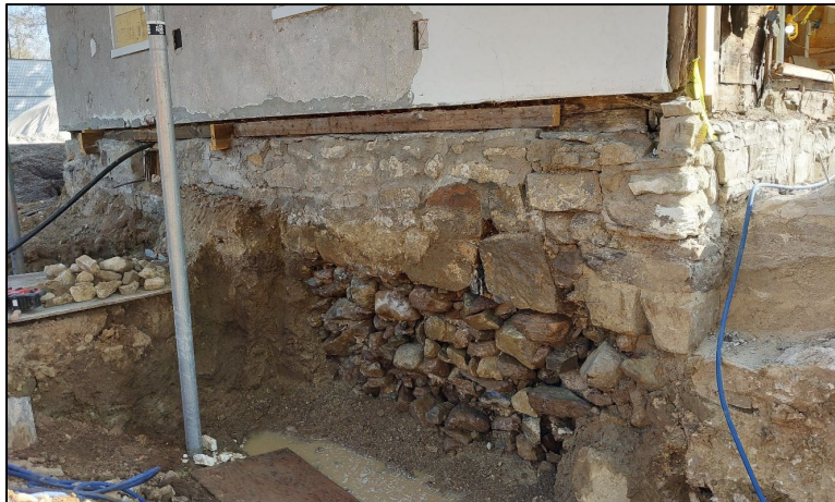
Photo 20. Aperçu du parement extérieur du mur de fondation ouest du bâtiment de l'hôtel de Ville. La distinction entre les portions hors-sol et en sous-œuvre (non jointées) sont très nettes. Vue vers le nord-est (BiFI-18-23-N2-71).
