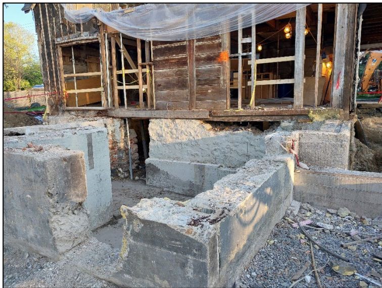
Photo 22. Vue d'ensemble des murs de fondation des annexes. On y voit l'ouverture pratiquée dans le mur arrière du bâtiment. Vue vers le nord-ouest (BiFI-18-23-N2-57).
